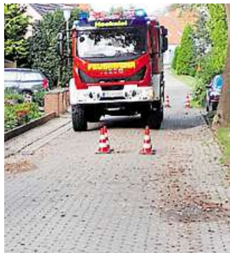
Die eingesackte Straße.
