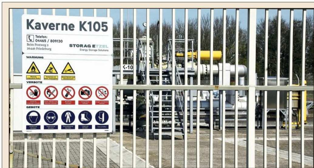
Die derzeit tiefste Bodensenkung im Kavernenfeld von 48 Zentimetern liegt bei der Kaverne 105 südlich der B 436, in der Nähe des blauen Pumpengebäudes. WZ-FOTO: GRABHORN
